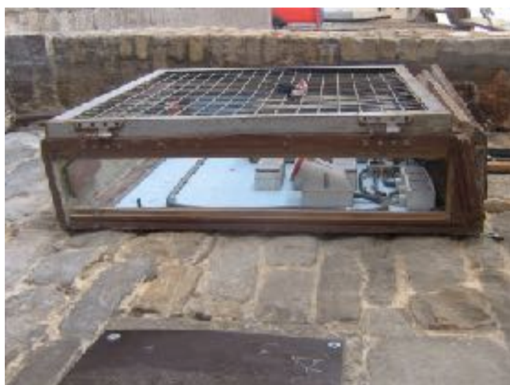
Prise triphasé 32 A 220v tétrapolaire + terre- à l'extérieur du bâtiment (voir plan)
